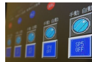
遠隔監視システム
