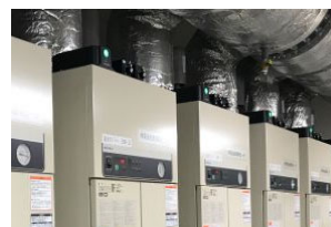
ボイラープラント
