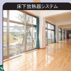
床下放熱器システム
