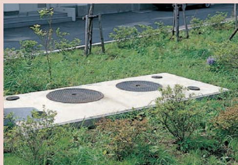
主タンク(埋設)
