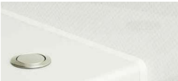
浴槽目地(樹脂目地) ※浴槽目地は人工大理石浴槽のみ。
