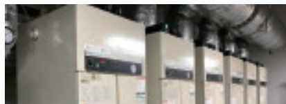
ボイラープラント
