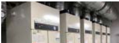
ボイラープラント
